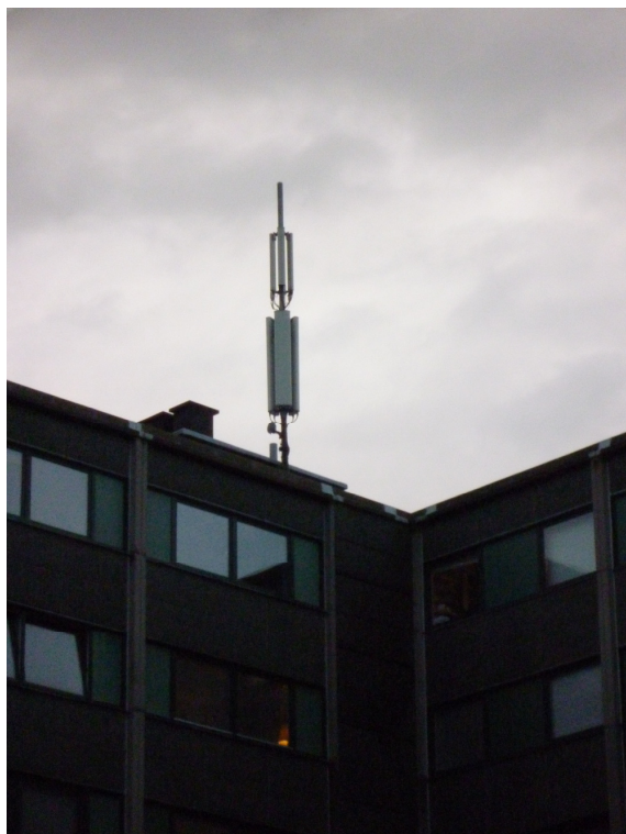
Bærerør med antenner monteret på tag.
